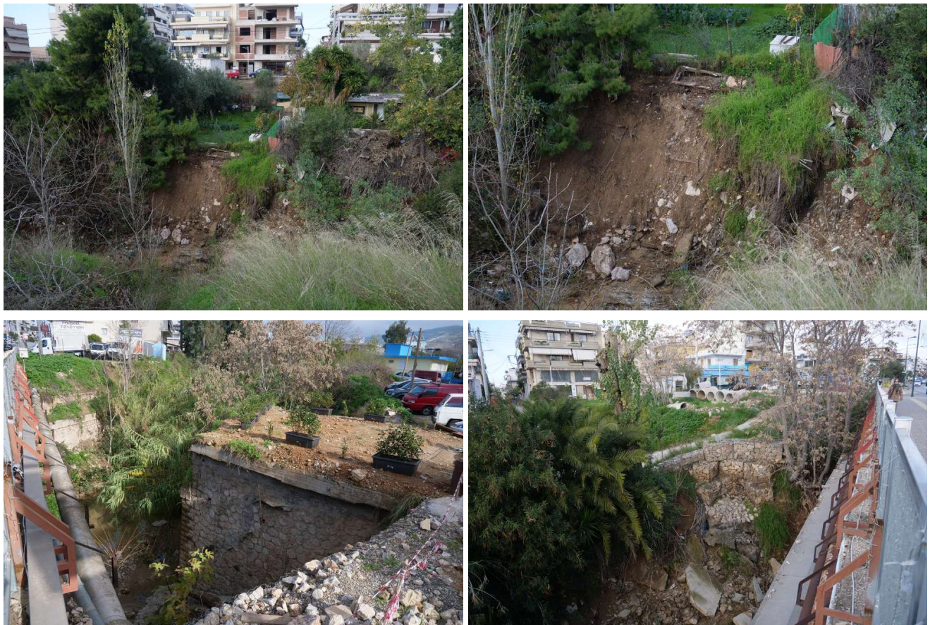
Εικόνα 11: Φωτογραφίες της κατολίσθησης στην περιοχή 4 (πηγή: αυτοψία BEYOND/FloodHub στις 27/12/2025)
