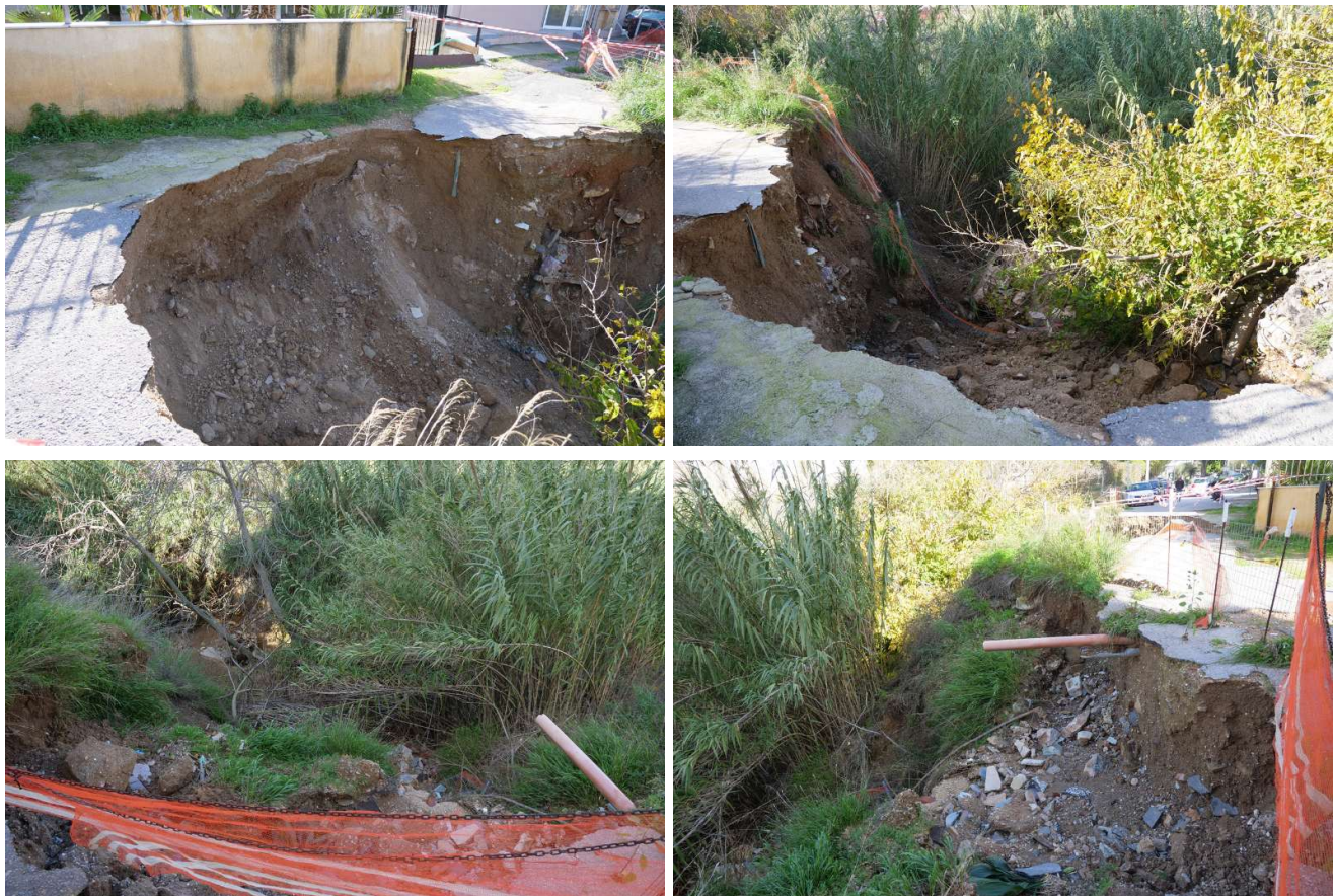
Εικόνα 14: Φωτογραφίες της κατολίσθησης στην περιοχή 5 (πηγή: αυτοψία BEYOND/FloodHub στις 27/12/2025)
