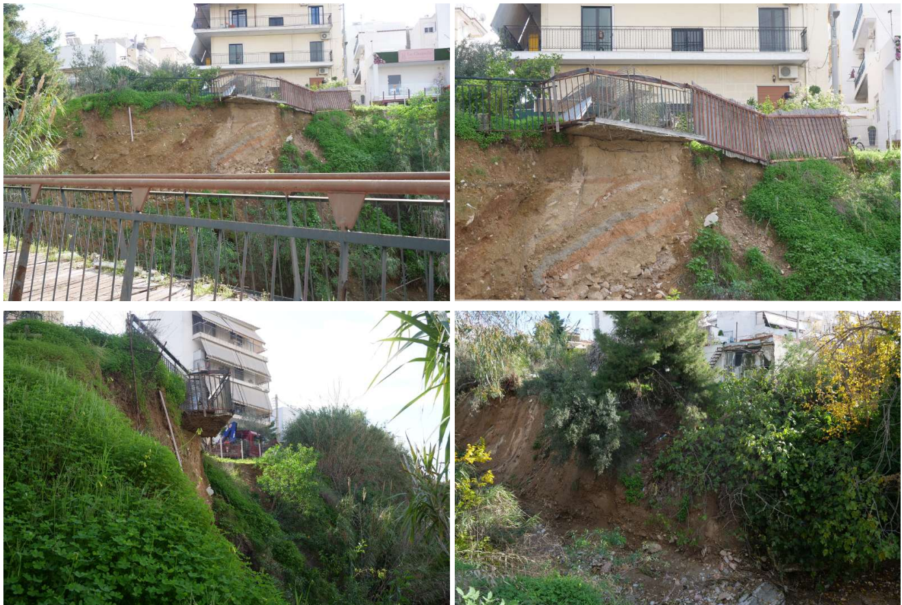
Εικόνα 17: Φωτογραφίες της κατολίσθησης στην περιοχή 6 (πηγή: αυτοψία BEYOND/FloodHub στις 27/12/2025)
