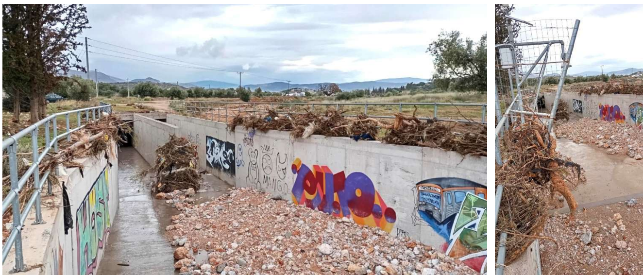
Φωτογραφίες 7 & 8 (στις 7/12/2025): Το ρέμα Αγίας Αικατερίνης στον σταθμό Εκτροπή μετά την κακοκαιρία Βυγον με φερτά υλικά ύψους 0,50 m
